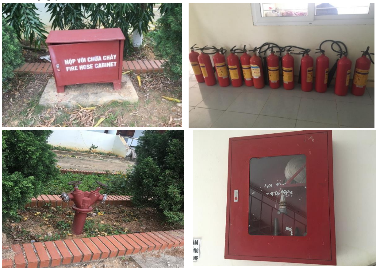
Hình 21. Một số trang thiết bị PCCC tại Bệnh viện
