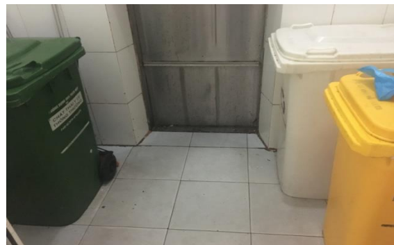
Khu vực tập kết rác tại tầng 1, có thang máy chuyên dụng vận chuyển rác
