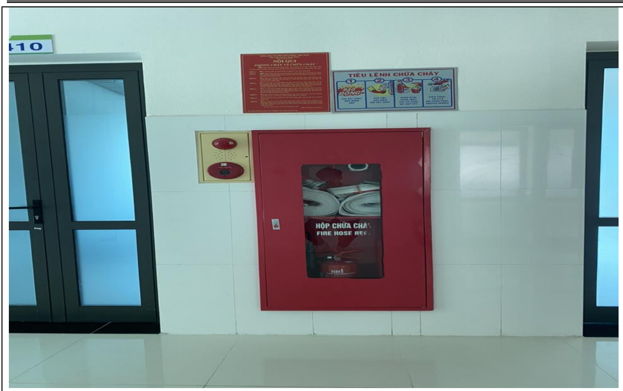
Hình 40. Hệ thống phòng cháy chữa cháy của bệnh viện
