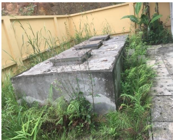
Hình 13. Bể cô lập CTNH (chôn vĩnh viễn)
